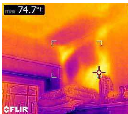
Нарушение изоляции – солнечный день E6 с функцией MSX
